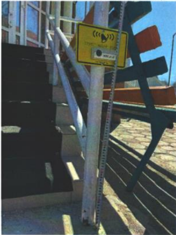
ФОТО № 11 Кнопка вызова на лестнице
